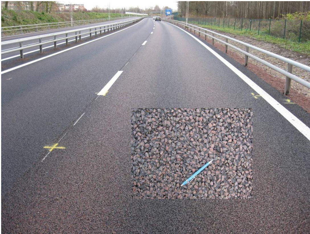
Figur 10. Nylagd gummiasfaltbeläggning, GAÖ 11, på Söderleden i Norrköping. Observera den dåliga bitumentäckningen av stenarna.
