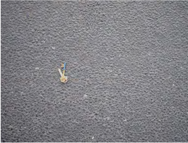
Bild 19 Foto från besiktningen (hjulspår) i oktober 2007, cirkulationsplatsen vid Smedjebacken.
